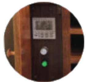
（上）デイリータイムスイッチ （下）スピードコントローラー
